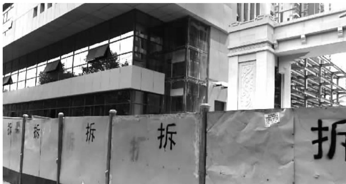
尽管多次收到监管部门的拆除指令，但陕西建工下属企业益兴建设违法建设的楼体至今仍未拆除。
