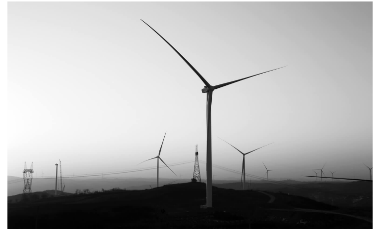
甘肃平凉125MW分散式风电项目。
