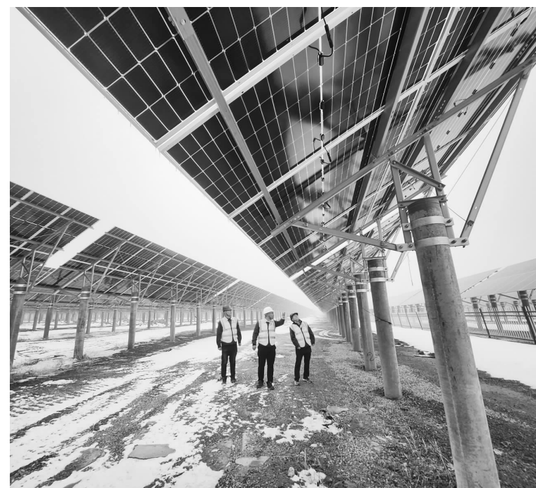
随着新能源发电装机规模迎来爆发式增长，关于消纳问题的关注度也越来越高。图为山东东营盐碱滩涂地50万千瓦光储一体化项目并网发电。
