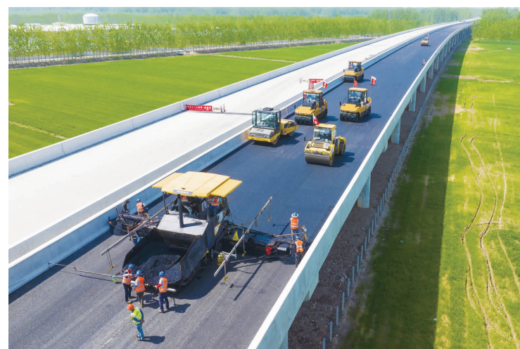
专家预计，二季度基建投资增速比一季度有所加快，增速在5%以上。图为江苏宿迁盐洛高速正在加紧施工。视觉中国/图
