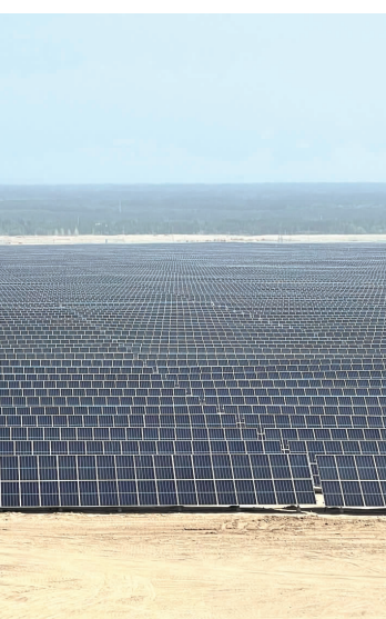
中广核和田洛浦100万千瓦光伏项目现场。
