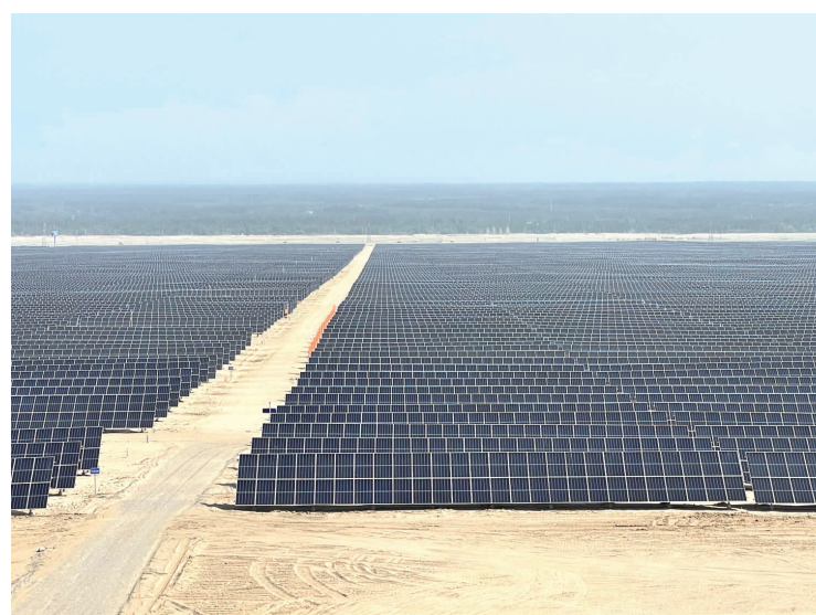
中广核和田洛浦100万千瓦光伏项目现场。
