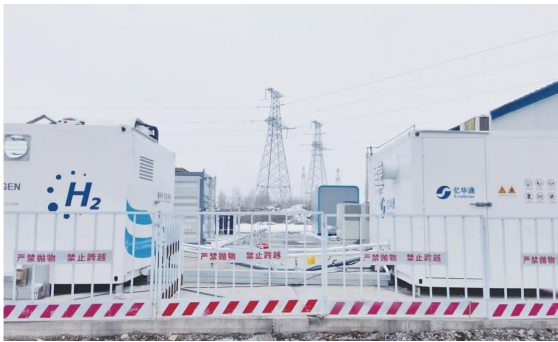
亿华通首套PEM电解水制氢设备。
