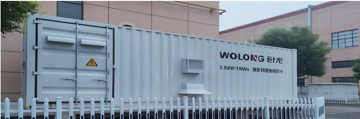
图为卧龙新能磷酸铁锂储能系统。
