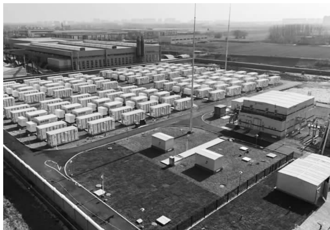
图为易储数智新蔡储能电站项目一期全景图。
