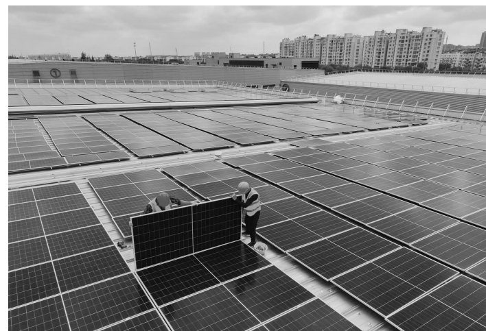
工人在江苏省如皋市长江镇一家复合材料企业屋顶安装分布式光伏发电装置。视觉中国/图
