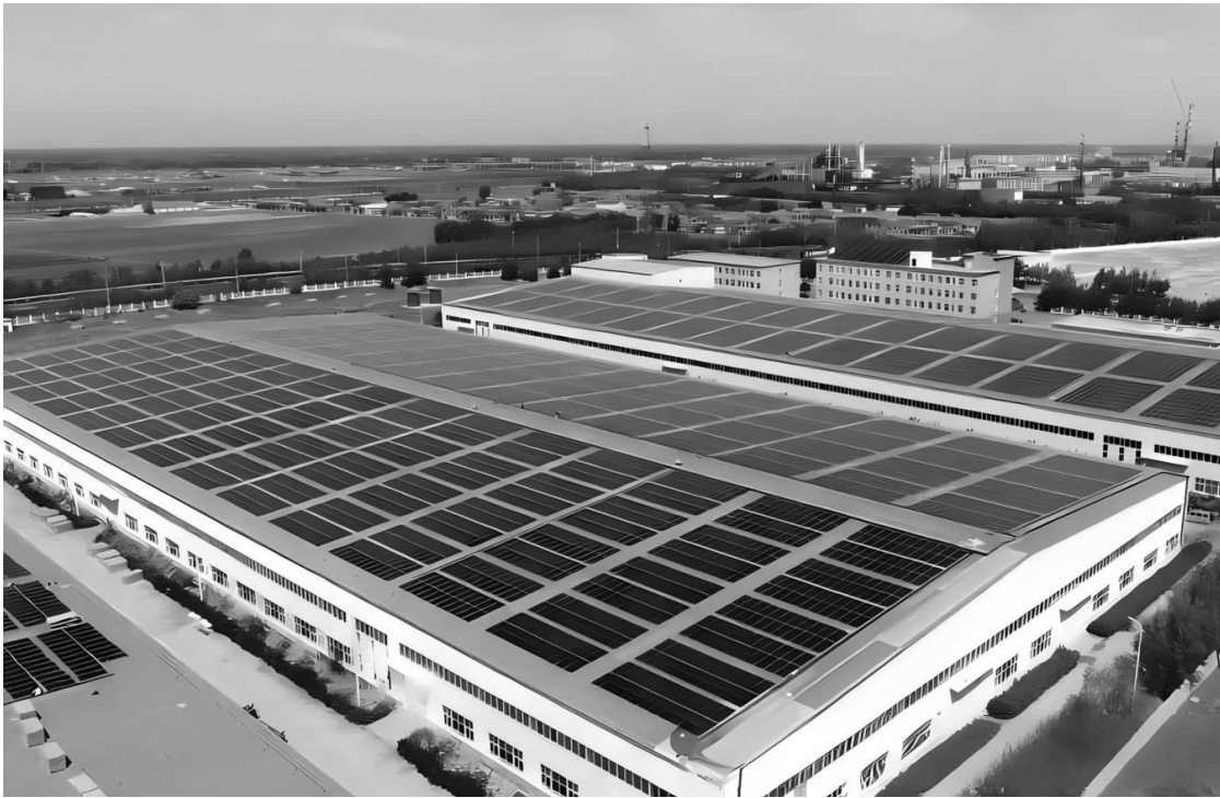
图为晨丰科技通辽电子电气产业园屋顶分布式光伏项目。
