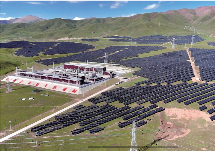
国能刚察县热水镇光伏园区,光伏板下牦牛悠闲吃草,构成了高原独有的绿电图景。
