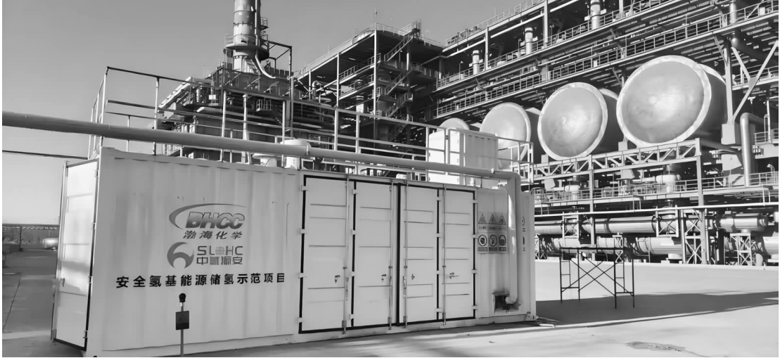
图为渤海化学全资子公司渤海石化安全有机液储放氢示范项目。
