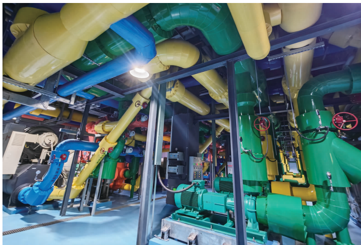
图为四川电信算力中心液冷站。
